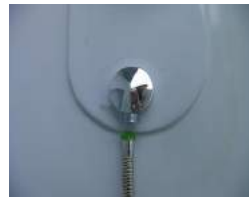
吐水口にシャワーホースを接続
